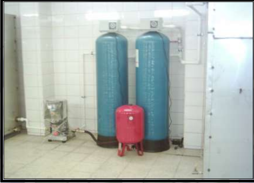
Bakırköy Lisesi Su Arıtma Tesisatı
